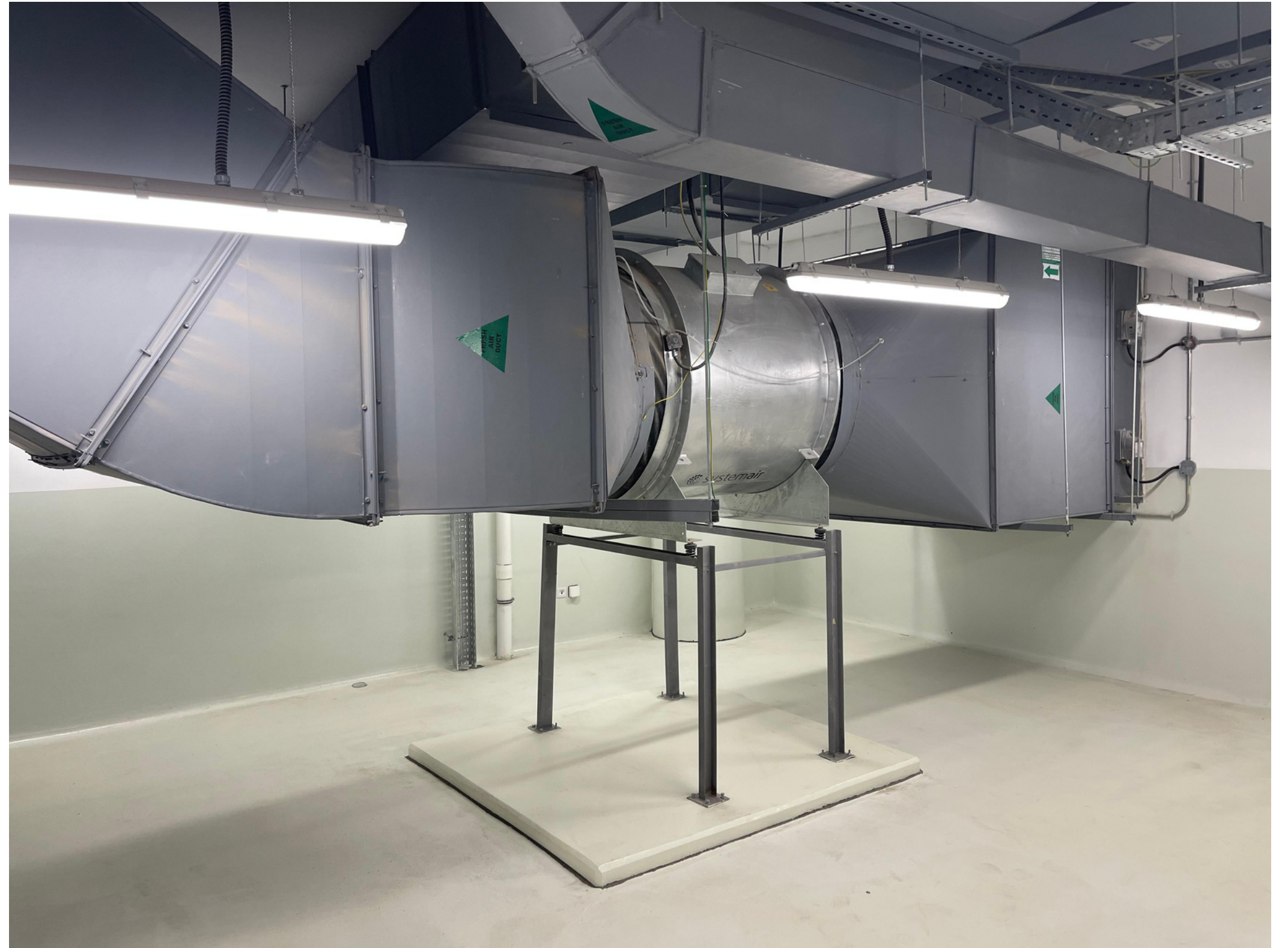
CAR PARK VENTILATION FAN
